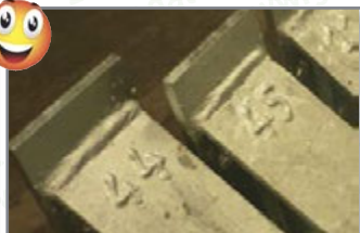
Photo 59 : Cordon de soudure
